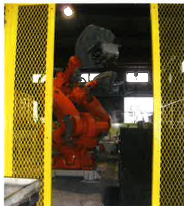
1号機ロボット(漬け込み)
